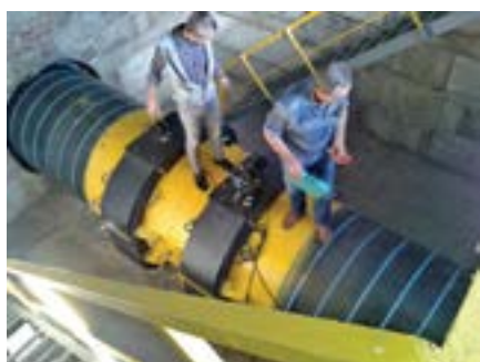
Рис. 6. Бункер со смонтированным УЗПР
