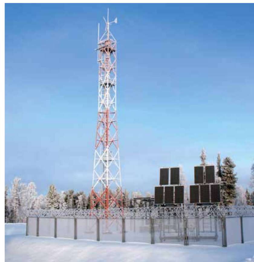
Комплекс телемеханики на возобновляемых источниках энергии
