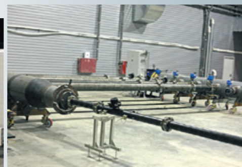
Рис. 14. Поверочный стенд на базе эталонных ультразвуковых расходомеров
