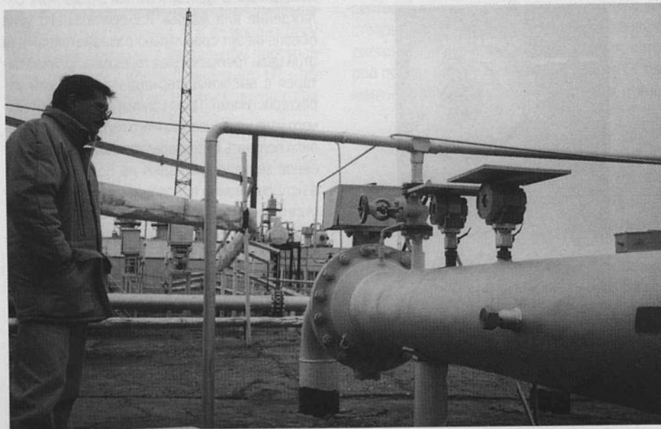
Эксплуатация прибора на газопроводе
